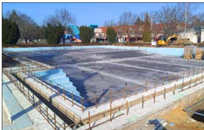
Az úszómedence modern vízforgató technológiát kap
